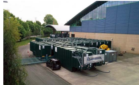
Schwerlastcontainer im Außenbereich
