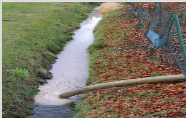
Einleitung des Bauwassers in ein Gewässer mit offensichtlicher Überschreitung der festgesetzten Grenzwerte
