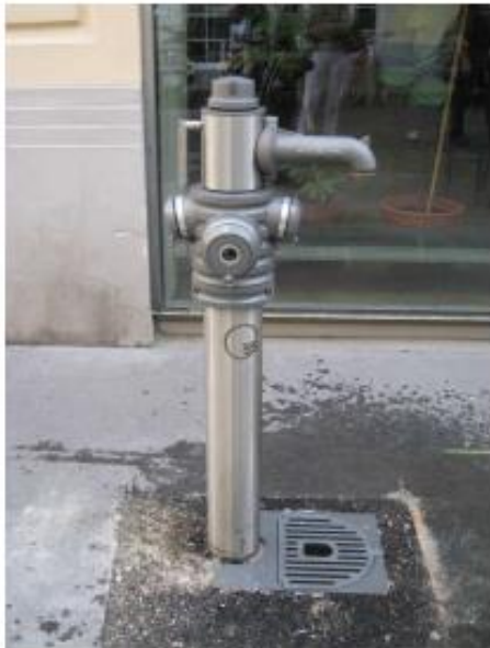
Abb.2: Trinkhydrant mit versenkter Ablaufschalte Quelle: MA31-Wiener Wasser
